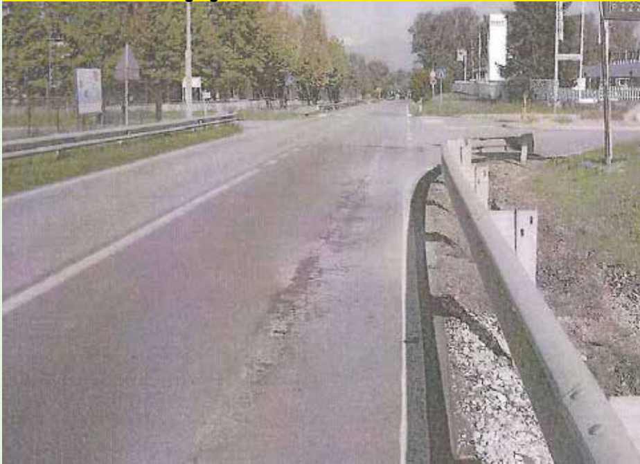
Dopo il 1° ripristino senza AUTOTENE ASFALTICO ANTIPUMPING HE/TVP da giugno 2013 a febbraio 2014 - 7 mesi
