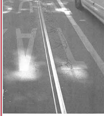
Agosto 2015 - Problemi ricorrenti nelle rotaie promiscue asfaltate
