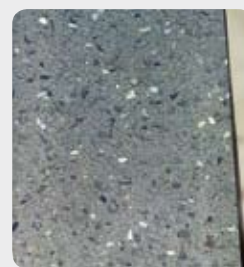
calcestruzzo a base sabbiosa di bassa qualità
